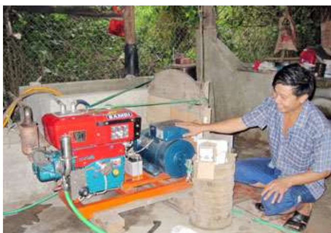
Hình 1.2.26. Máy phát điện chạy KSH tận dụng động cơ cũ
