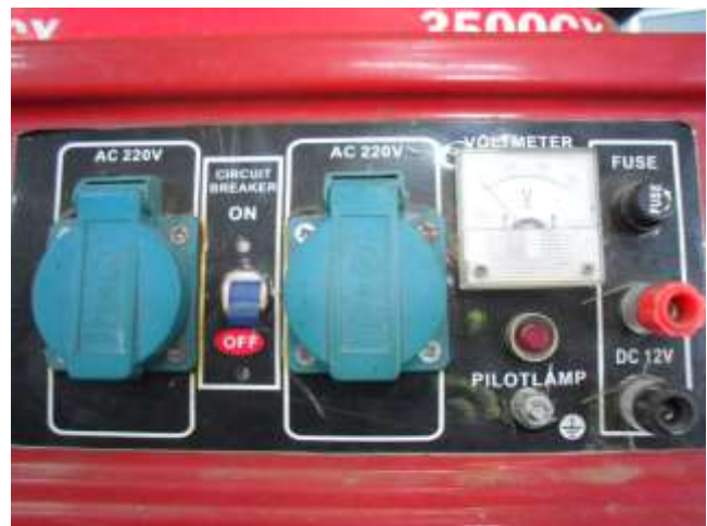
Hình 5.68. Điện áp ngõ ra trên bảng điều khiển tổ máy phát điện
