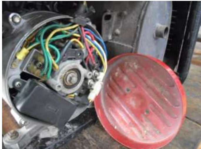
Hình 5.3. Hộp cực máy phát điện
