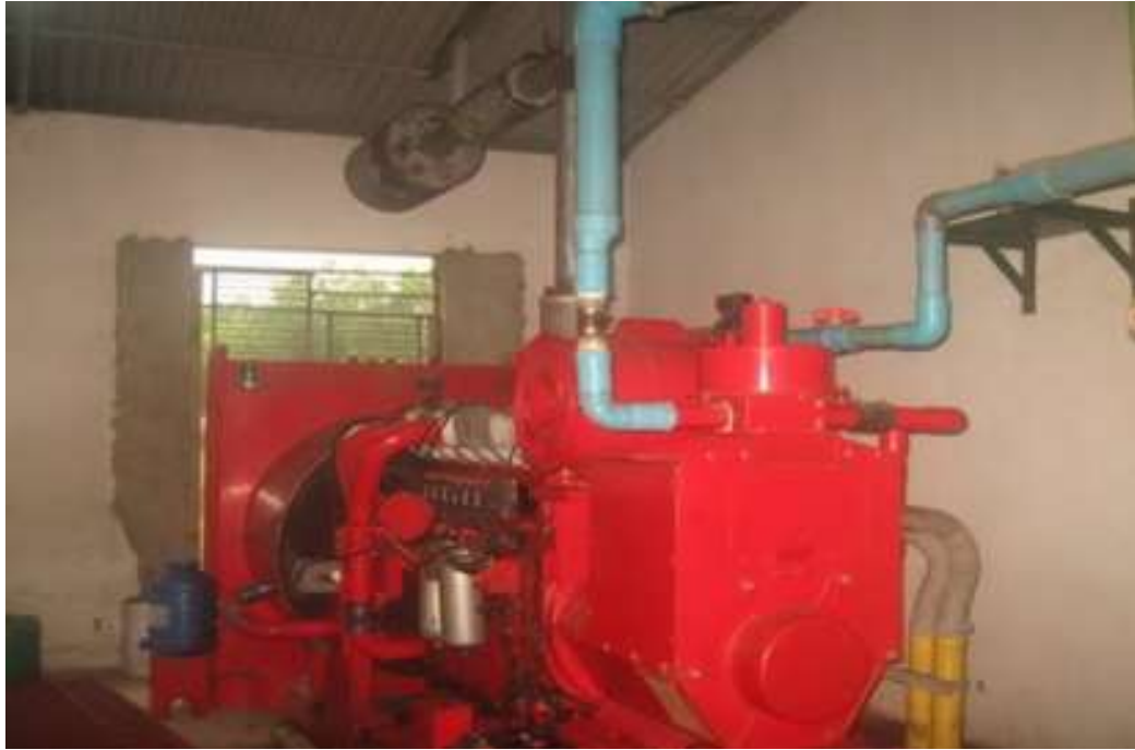
Hình 3.2. Hệ thống thải khí của một tổ máy phát điện
