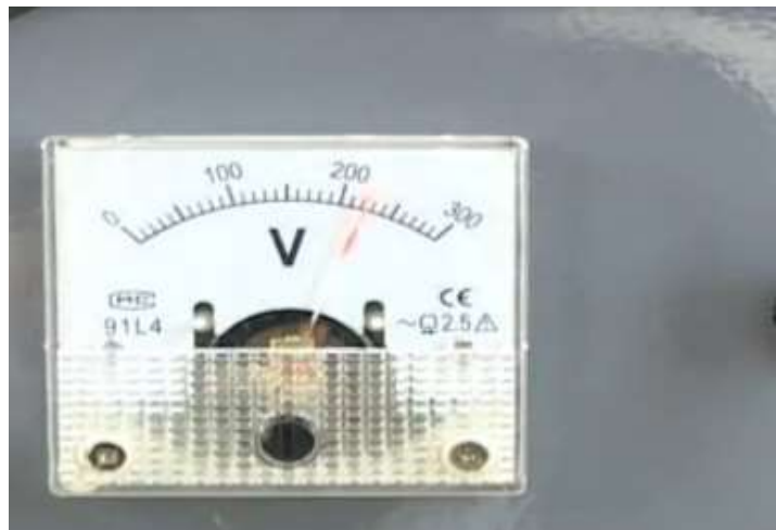
Hình 4.13. Quan sát điện áp máy phát qua đồng hồ
