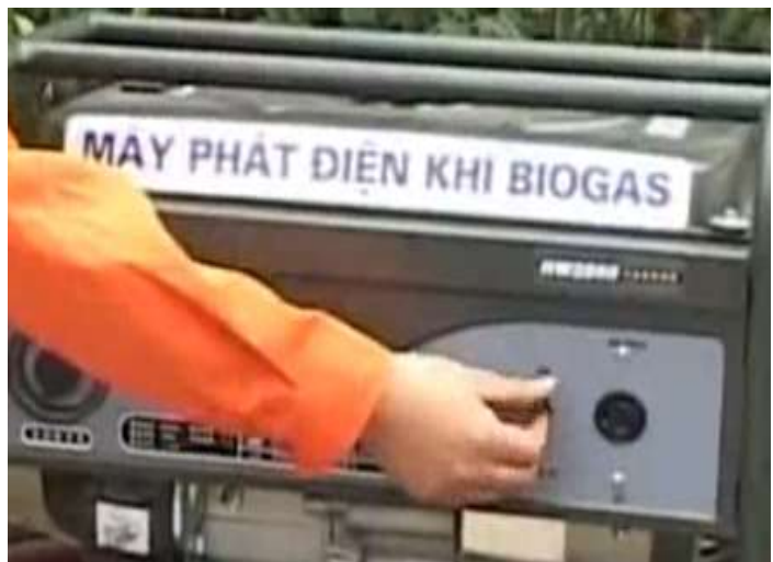
Hình 4.14. Đóng CB tổ máy phát điện cấp nguồn cho tải
