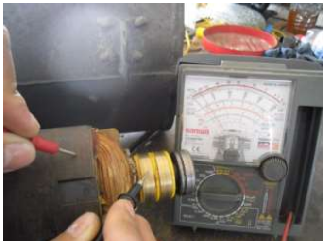
Hình 5.47. Đo cách điện cuộn dây roto
