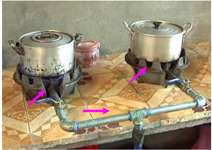
Hình 1.4.20. Các van khí được lắp trên ống dẫn khí
