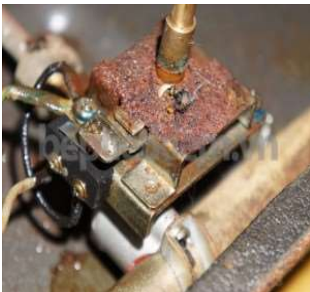
Hình 2.2.31. Cốt của nút vặn bị rỉ sét
