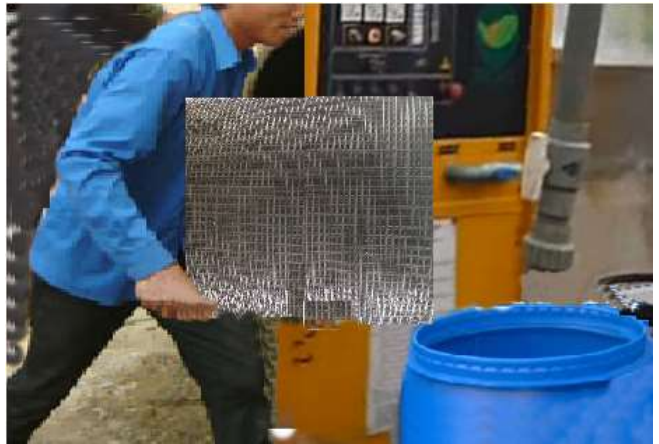
Hình 7.17. Lắp lưới lọc mới
